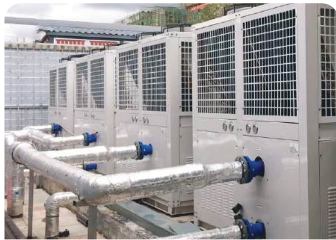
Hệ thống nước nóng trung tâm tòa nhà hội nghị
