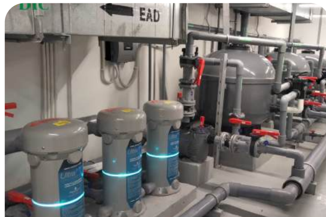
Phòng kỹ thuật bể bơi Hyatt Hạ Long Bay
