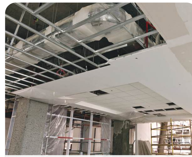
Hệ thống thông gió và điều hoà không khí
