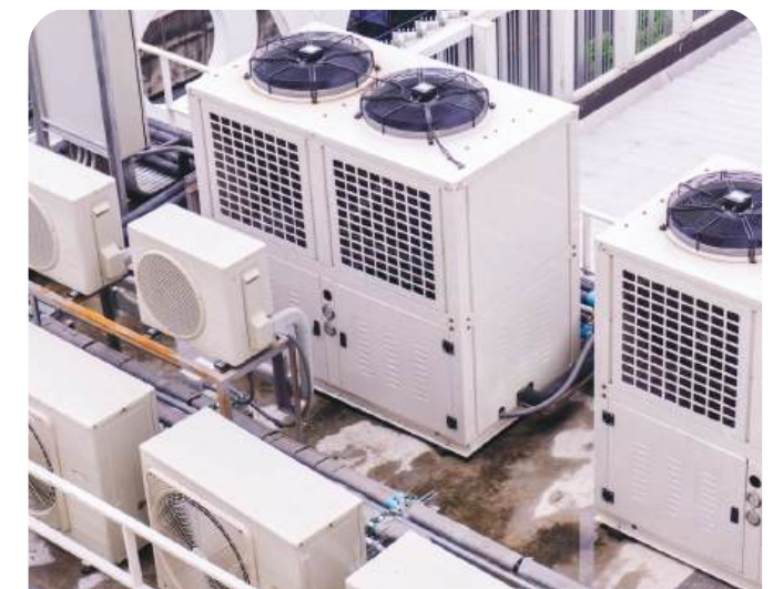
Hệ thống bơm nhiệt bể bơi bốn mùa
