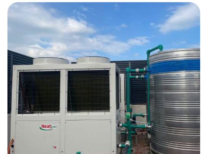
Hệ thống bơm nhiệt nước nóng toà nhà
