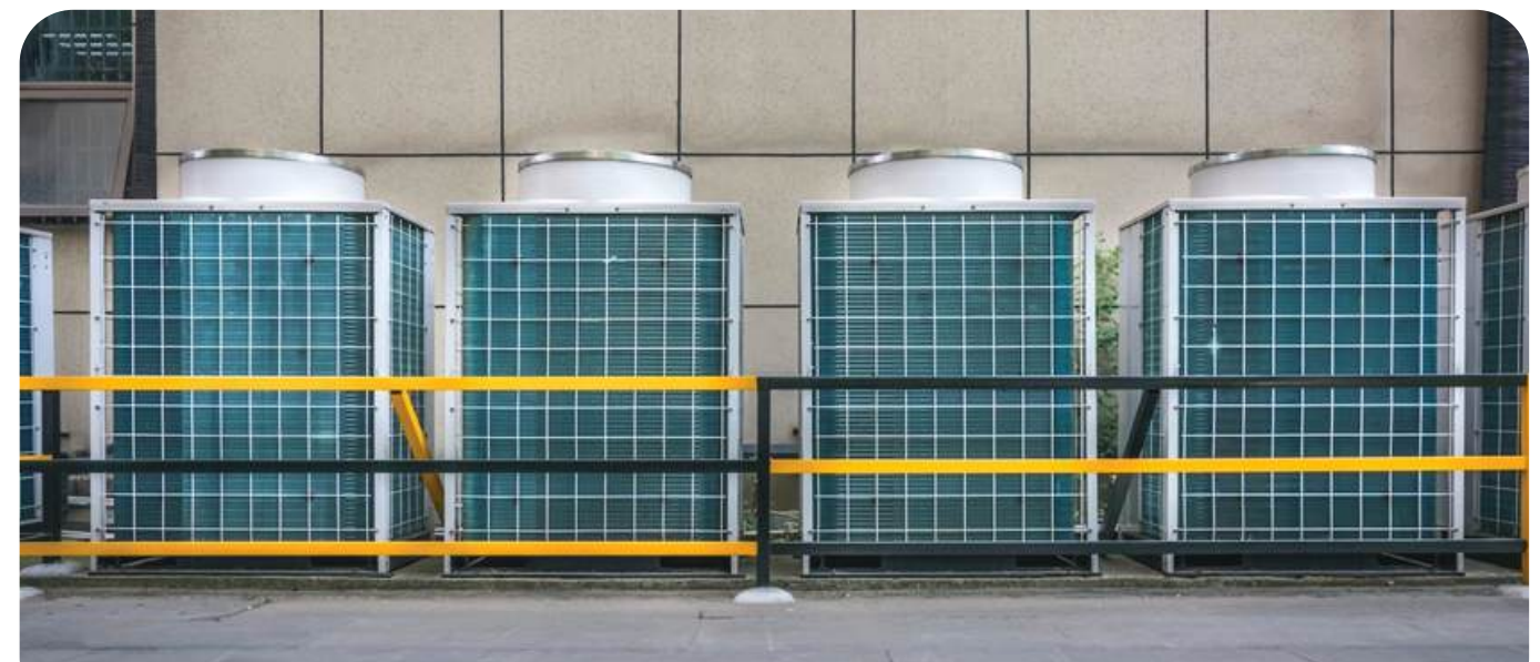
Hệ thống bơm nhiệt nước nóng trung tâm khu nghỉ dưỡng
