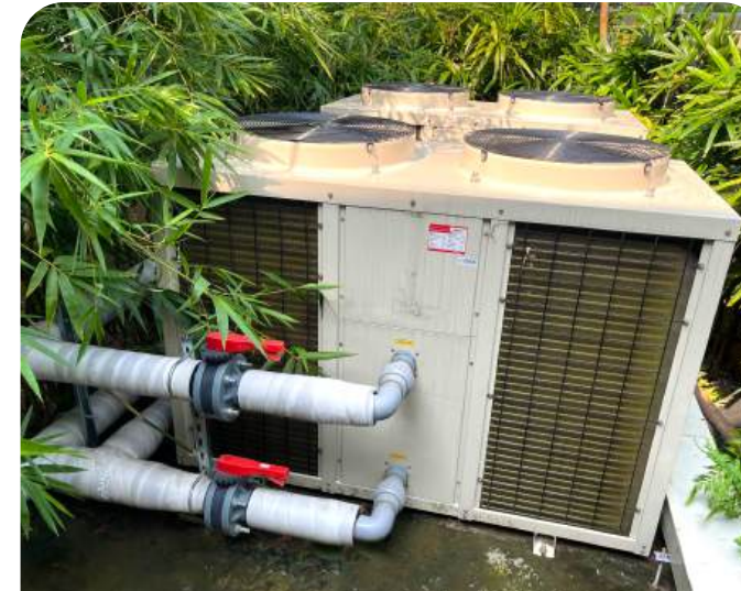
Bơm nhiệt dự án Wyndham Thanh Thủy
