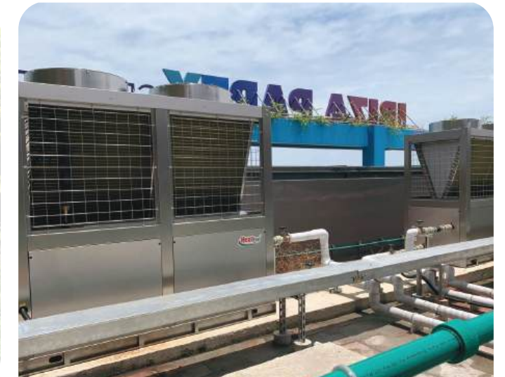
Bơm nhiệt dự án Flamingo Thanh Hoá
