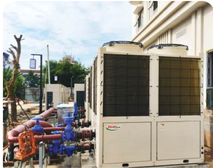
Hệ thống bơm nhiệt Viện dưỡng lão Phương Đông Asahi
