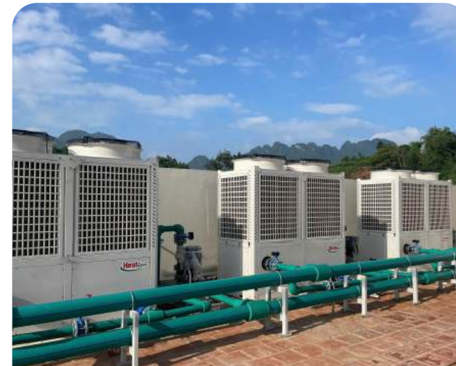
Hệ thống bơm nhiệt bể Onsen khu nghỉ dưỡng
