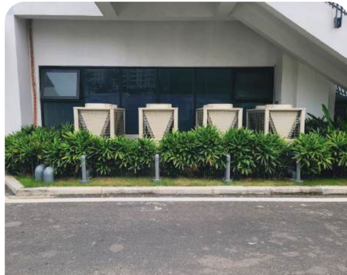
Bơm nhiệt nước nóng dự án Tây Hồ Tây
