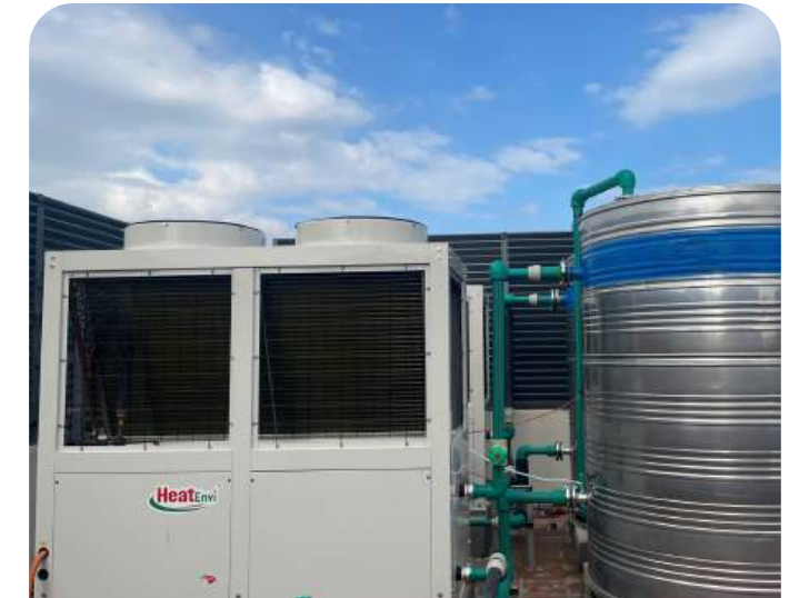
Hệ thống bơm nhiệt dự án Venus Resort - Hòa Bình
