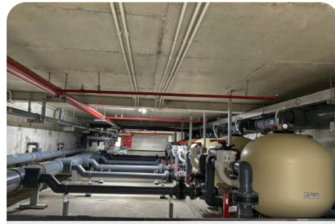
Phòng máy bể bơi bốn mùa tại Kim Chung - Di Trạch
