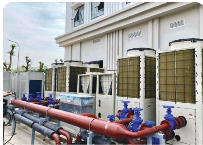
Bơm nhiệt dự án Viện dưỡng lão Phương Đông Ashahi
