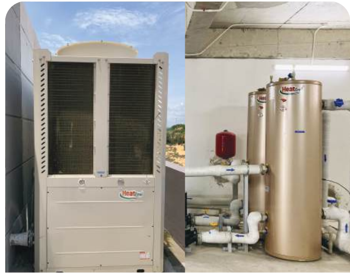
Hệ thống nước nóng bể khoáng Apec Mũi Né
