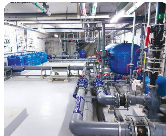
Phòng máy kỹ thuật bể bơi bốn mùa tòa nhà Flamingo
