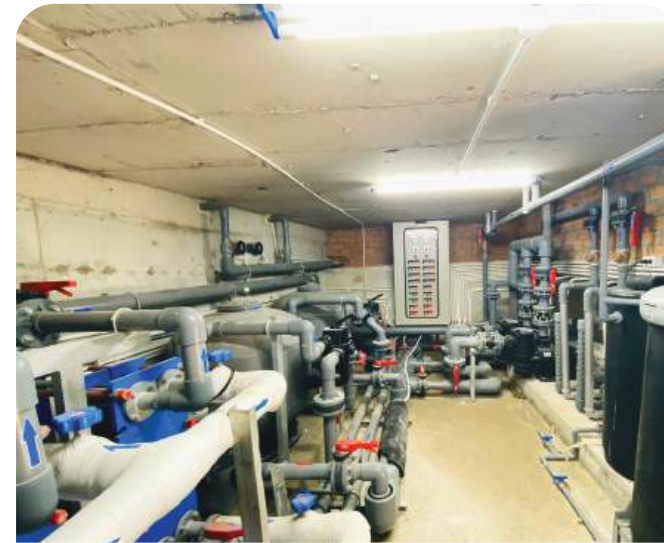
Phòng máy dự án Fuji Thanh Thủy
