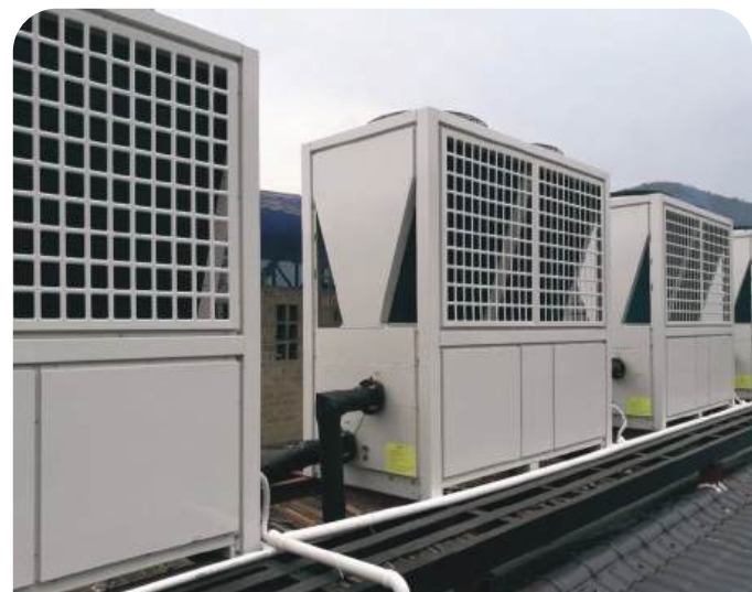
Hệ thống nước nóng trung tâm tòa nhà Dolphin
