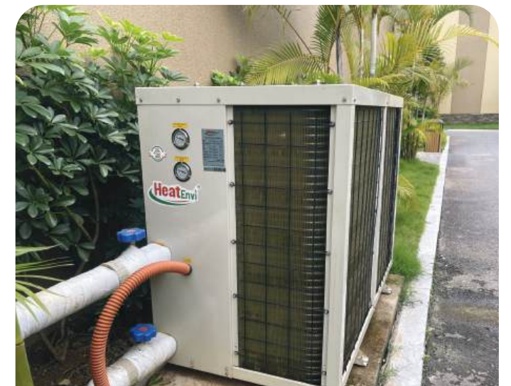
Bơm nhiệt dự án Apec Mandala Retreats Kim Bôi
