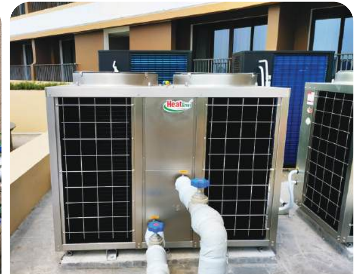
Hệ thống bơm nhiệt khu tổ hợp nghỉ dưỡng Quảng Ninh
