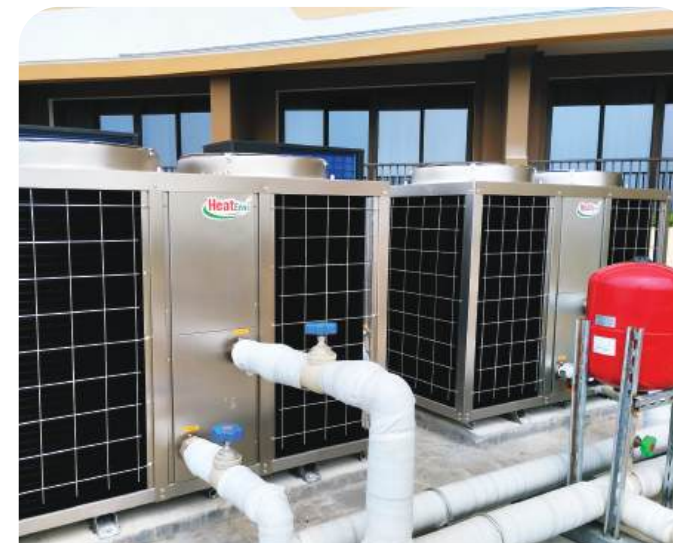
Bơm nhiệt dự án Sonasea Vân Đồn Harbon City
