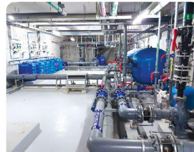
Phòng máy kỹ thuật bể bơi bốn mùa tòa nhà Flamingo
