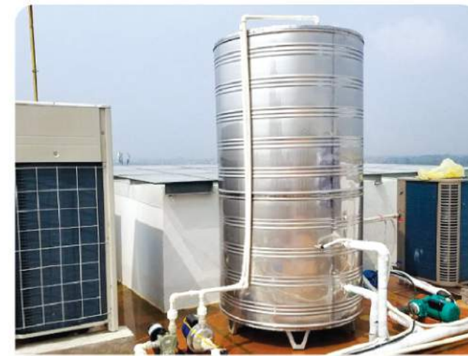
Hệ thống nước nóng biệt thự nghỉ dưỡng Bãi Cháy
