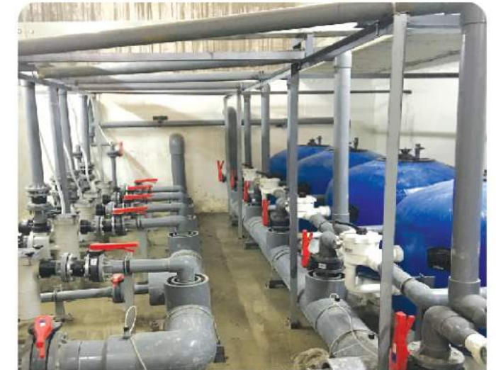
Phòng máy lọc nước bể tạo sóng 1700m2
