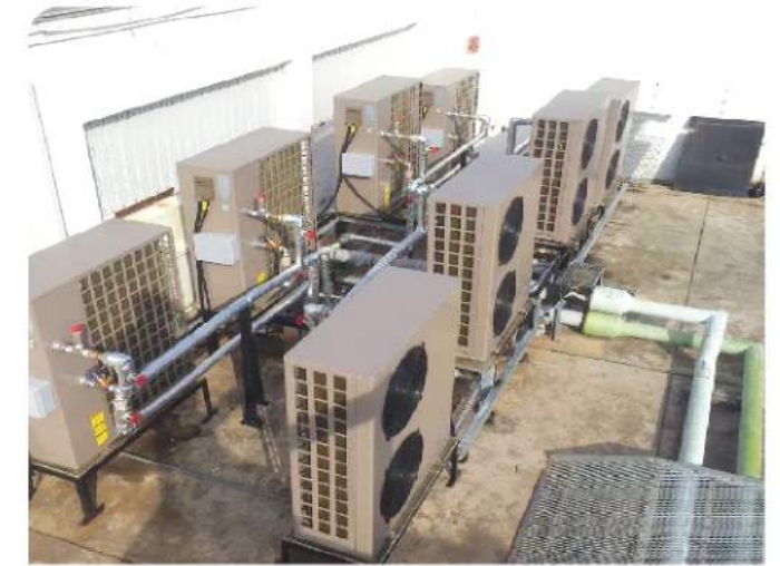
Hệ thống nước nóng bệnh viện
