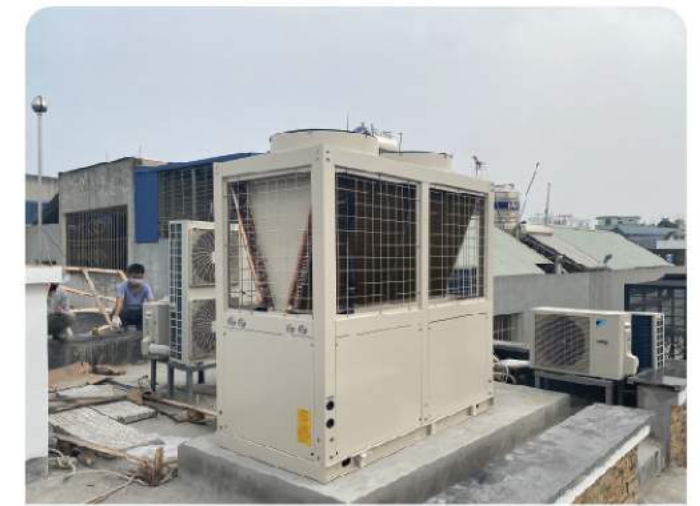
Hệ thống bơm nhiệt bể bơi bốn mùa Flamingo Đại Lải
