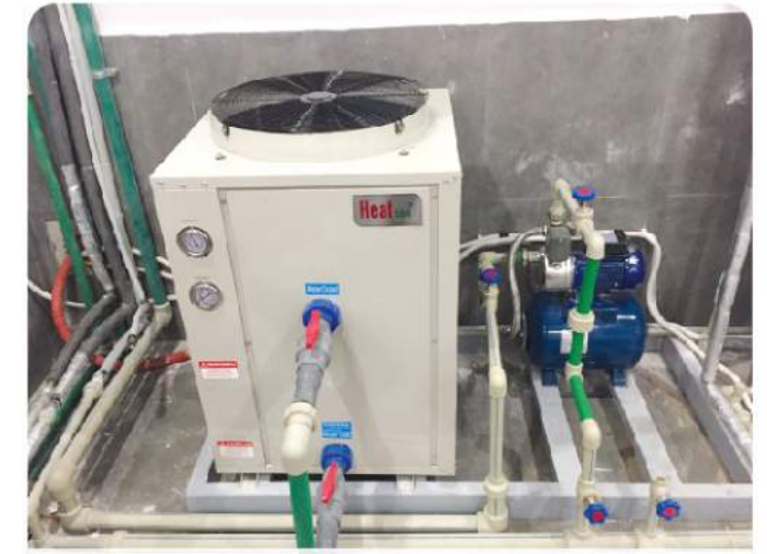
Hệ thống bơm nhiệt bể bơi bốn mùa biệt thự Sơn La
